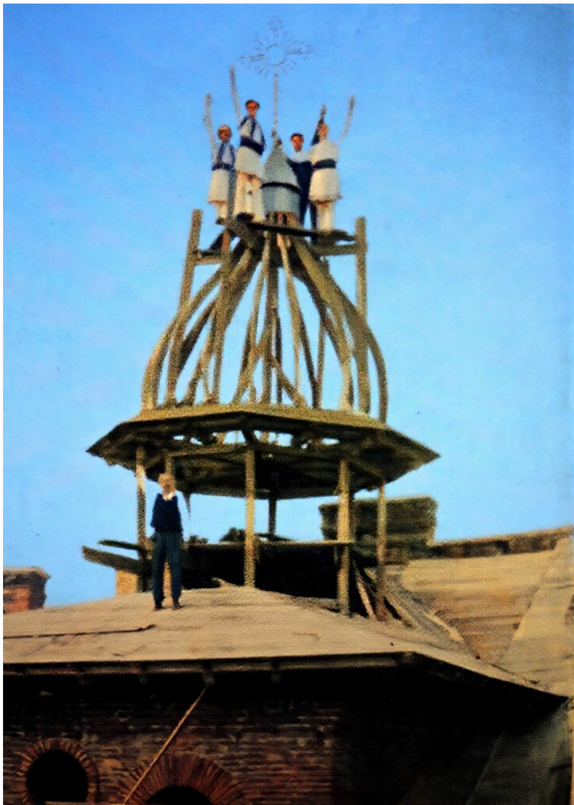
Căminul de la Râpa Galbenă din Iași, construit de legionari. În imagine, lucrările avansate ajunse până la cupola construcției...
