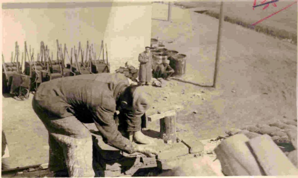
Inasul Nou Poarta Albă. Clădirea L. V. F. Refacerea unui cos din cauza construcției greșite. - (construită fără plan)
