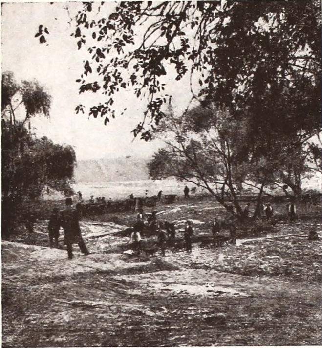
Fig. 30. — Lucrările de excavare a fundului viitorului lac Floreasca sunt dificile din cauza apei și nămolului.
